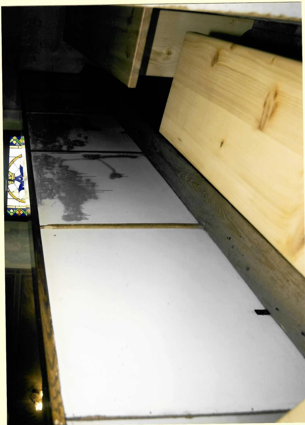
Fot. 13. Biały Kościół. Kościół parafialny p.w. Św. Mikołaja. Prospekt organowy i empora chóru muzycznego. Odwrocie balustrady empory chóru muzycznego. Widoczna wymiana wykonana z laminowanej płyty pilśniowej. Stan zachowania przed konserwacją Fot. Antoni Guzik, 2021.
