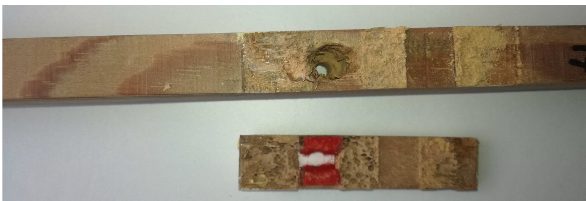
Uszkodzenia wywołane przez drewnojady.
